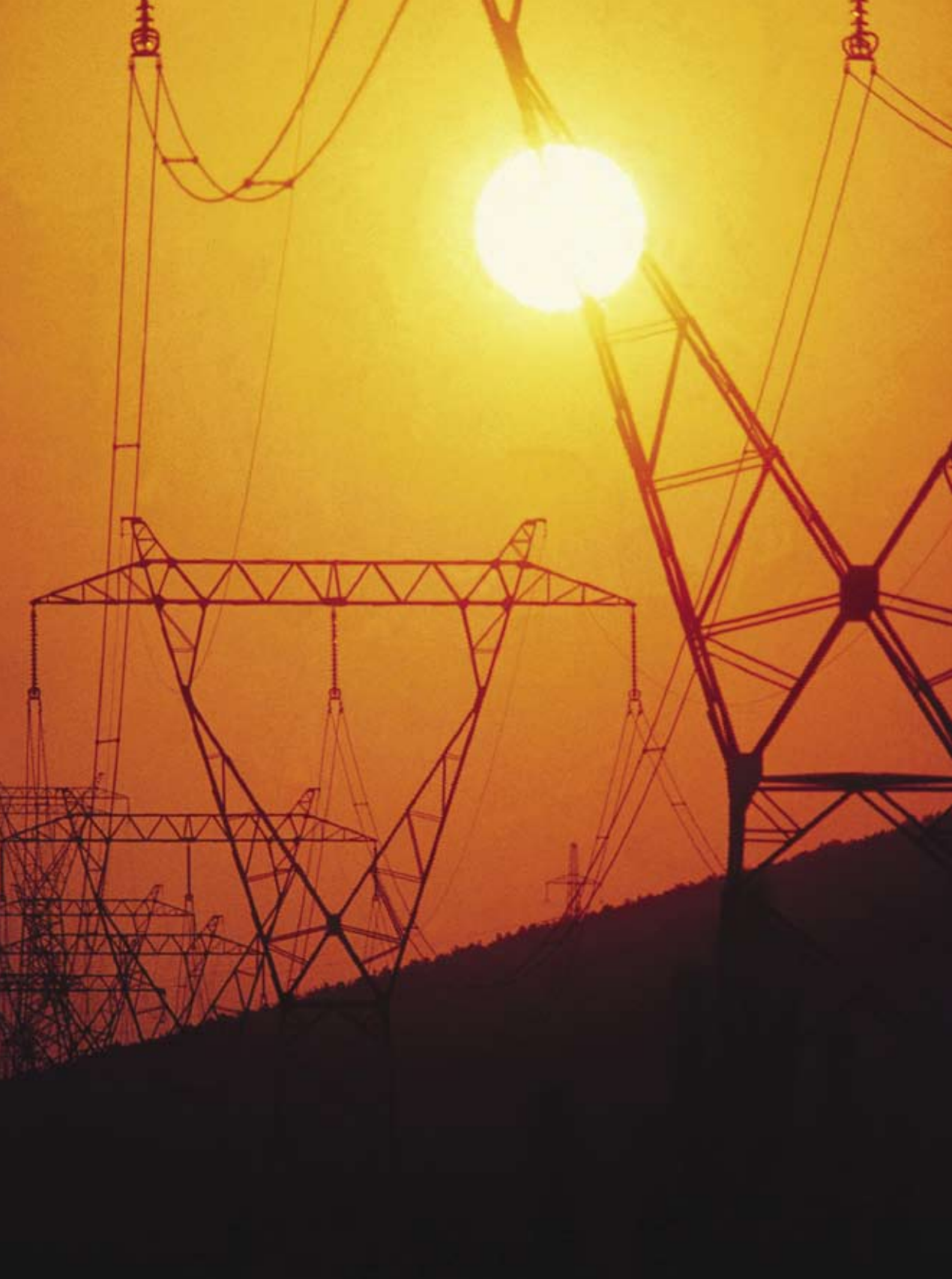
Dalekovod 400 kV u Dalmaciji
